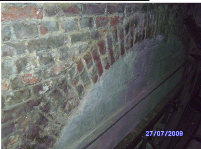
Kelder: zichtbaar dat een gang dichtgemetst werd.
