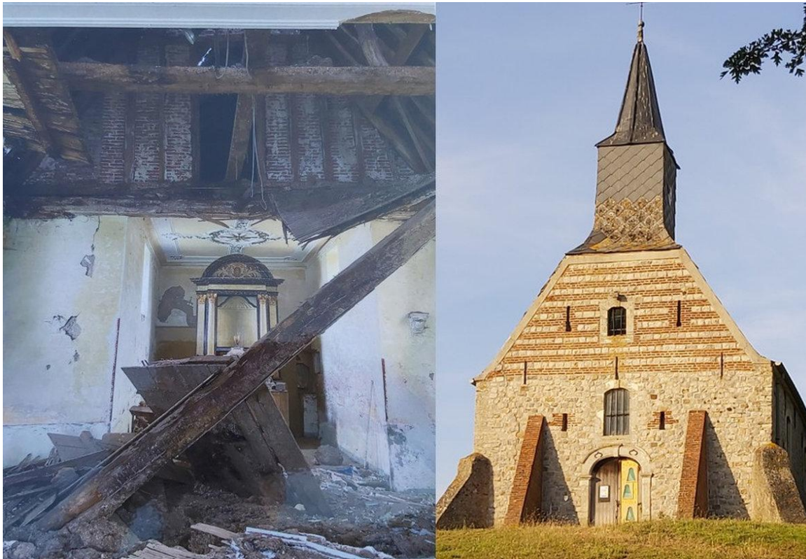
Figuur 18 Het ingevallen plafond van de Vlooienskapel in Rommersom
