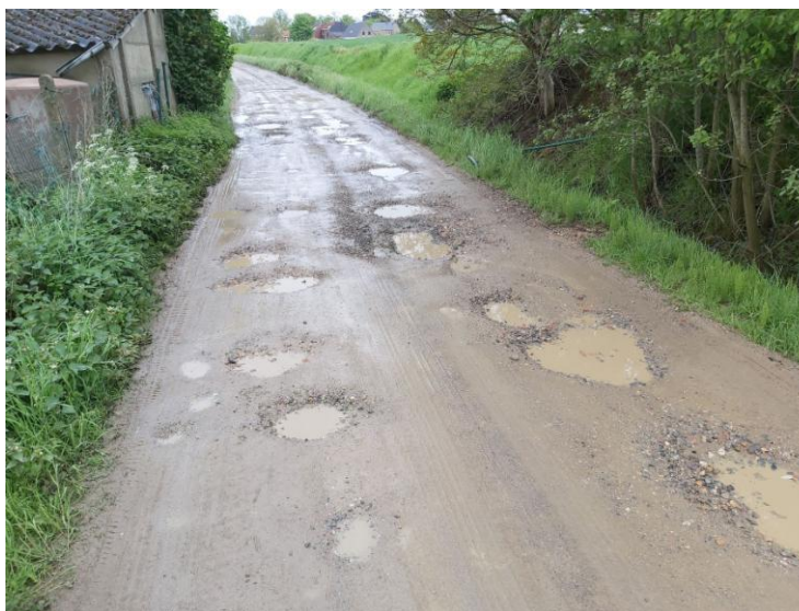
Figuur 16 Veel gaten in de omleidingsweg. Een steeds terugkerend euvel
