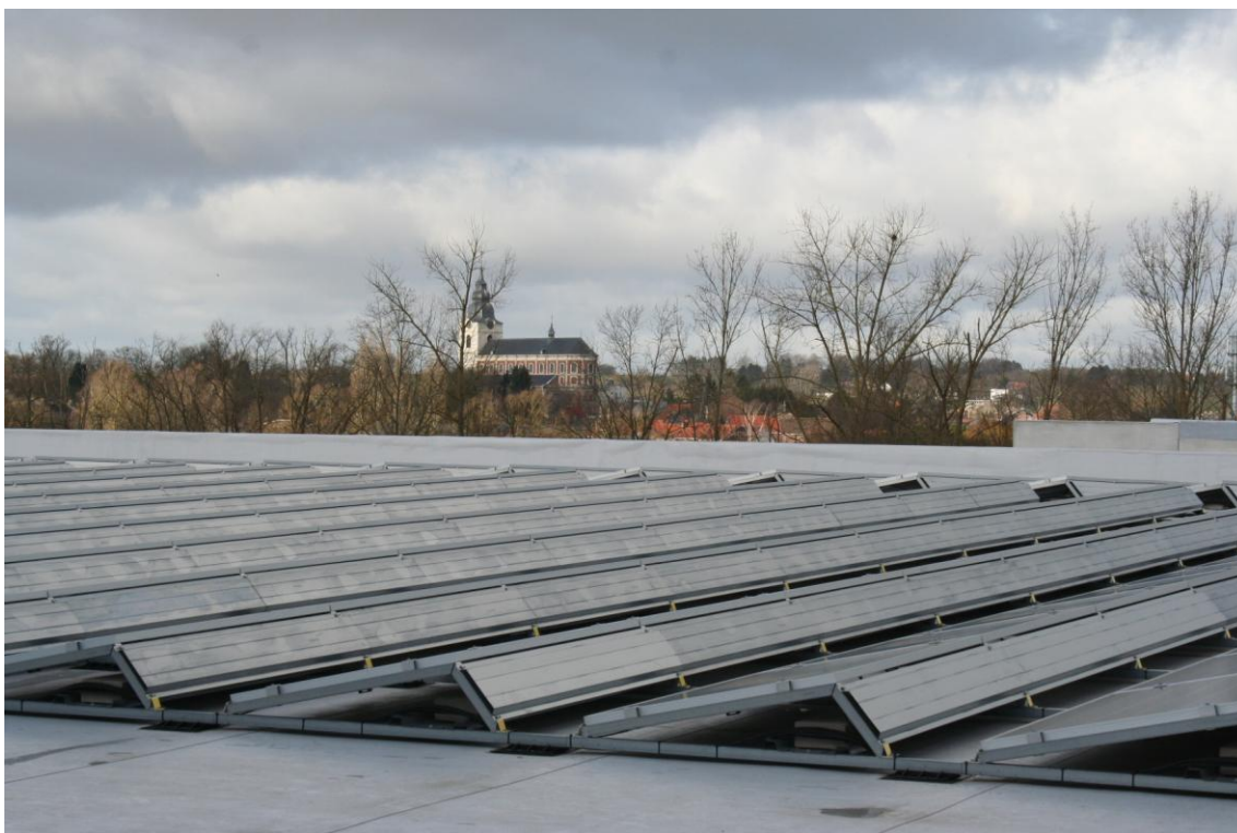
Figuur 14 Zonnepanelen op het dak van het nieuwe gebouw van AB InBev in Altenaken. Van op het dak ook een mooi zicht op Hoegaarden
